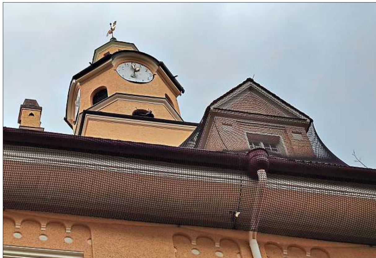
Schon vor drei Jahren musste das Dach mit Netzen gesichert werden. Jetzt soll die Konstruktion statisch ertüchtigt werden. – Fotos: Corinna Anton
